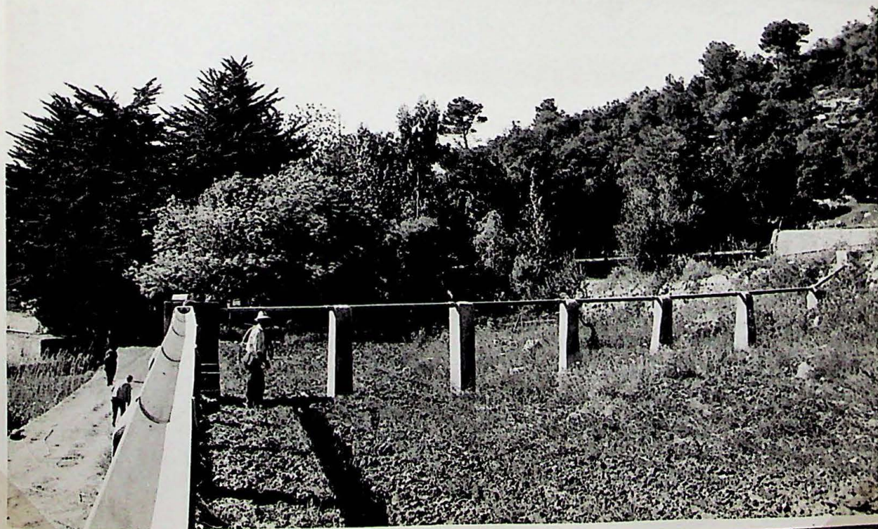
Vivero Central de "Manut" Conducción de agua, procedente de aljibes, por medio de tubos de uralita, con sus arquetas.
